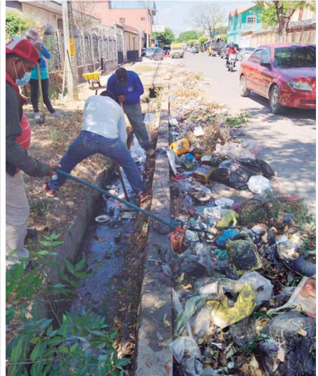
La basura acumulada en las cunetas fue retirada por personal de campo del departamento de Obras Públicas.
