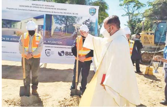
El padre Luis Ríos bendijo el comienzo de los trabajos de construcción de las nuevas instalaciones policiales en Tela, Atlántida.
