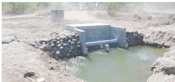
Con la construcción de la caja hidráulica, se capta más agua del río Choluteca y bombearla hasta la planta procesadora.
