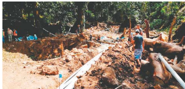
Antes de construir viviendas nuevas para los damnificados, es necesario reparar las vías de acceso.
