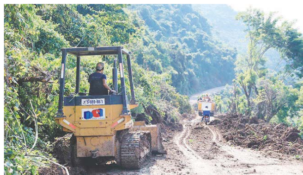
Las vías dañadas en los municipios cafetaleros ponen en riesgo la cosecha de café, por lo que son rehabilitadas.
