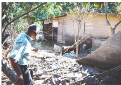
Iriaco Gómez perdió parte del muro de su casa. El agua estancada hizo que colapsara.
