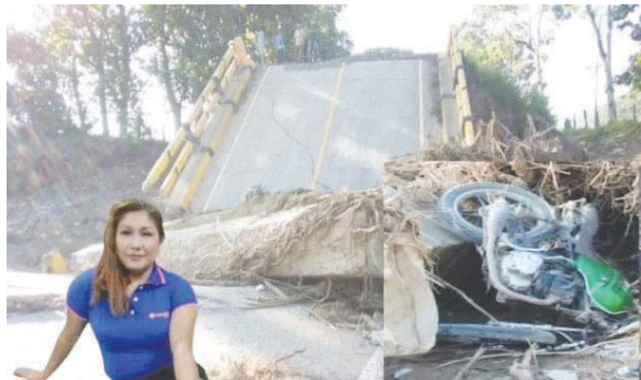
La moto chocó contra la infraestructura dañada y la pareja voló por los aires hasta caer, varios metros adelante, contra promontorios de tierra y piedras.
