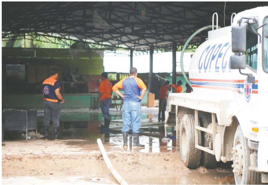
Los frentes de trabajo ayudarán en las labores de limpieza y rehabilitación en los sectores de la Rivera Hernández y Chamelecón, San Pedro Sula.
