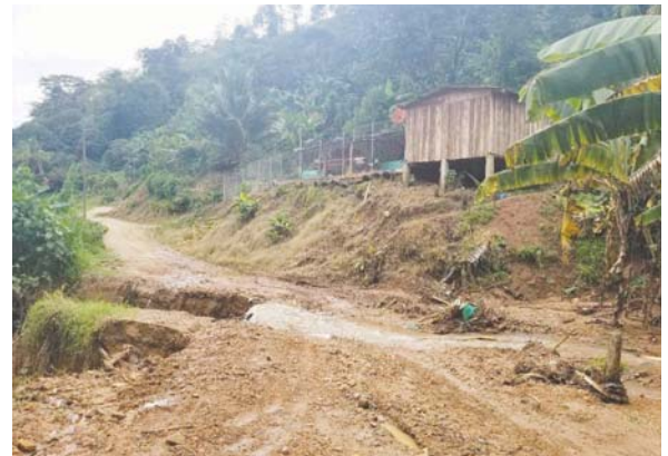
Varios tramos carreteros permanecen intransitables debido a que las lluvias continúan en la zona montañosa.
