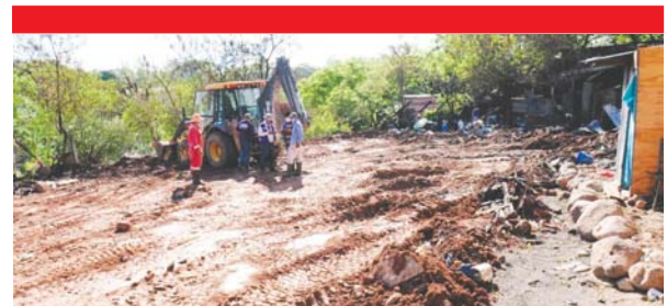
Personal de limpieza de la alcaldía recogió los escombros de las casas quemadas.
