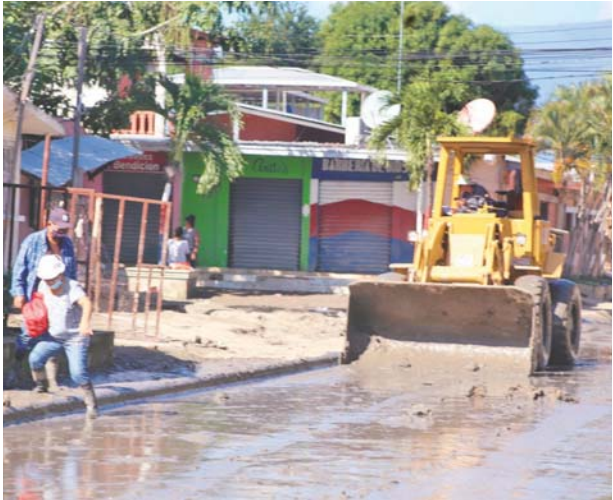
Los drenajes de las aguas lluvias quedaron obstaculizados, otra labor que se tiene que hacer, es destaparlos.
