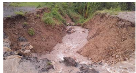
El desbordamiento de ríos y quebradas labró boquetes en carreteras.
