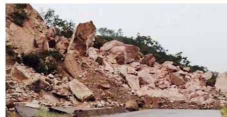
Por ahora en uno de sus trayectos del “Canal Seco”, está incomunicado por derrumbes que dejó a su paso la tormenta ETA.
