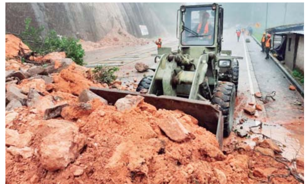
Personal del Primer Batallón de Ingenieros reparó un deslizamiento de tierra que se produjo en el kilómetro 131 de la carretera CA-5, en el sector de El Carrizal-Taulabé, Comayagua.
