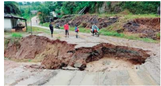
Enorme corte en la carretera de río Arriba, en la zona de Trojes.
