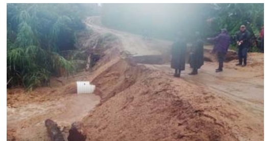
El corte en la carretera en Buena Vista, Trojes, por daños en una caja puente.
