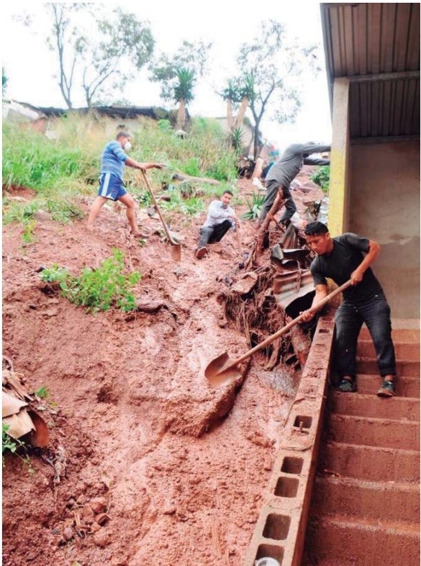
Los habitantes de la colonia Villanueva, al oriente de la capital, lamentaron que las lluvias provocaron derrumbes.
