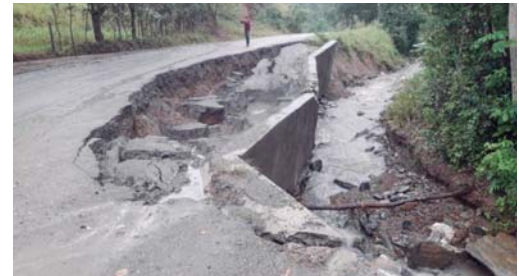
Severos deslaves en la carretera provocados por la fuerza incontenible del agua.
