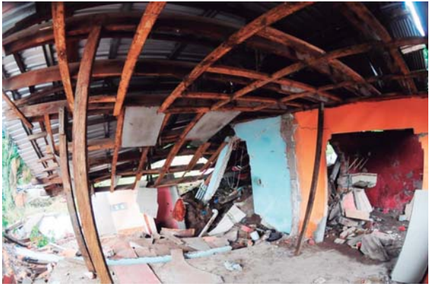
En la colonia El Reparto por Arriba se produjeron deslizamientos que hicieron ceder las paredes de varias viviendas.
