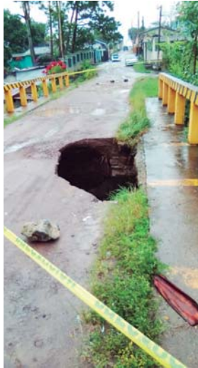
El enorme cráter en la loza del puente no permite la circulación de peatones y vehículos.
