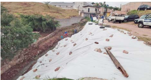
Las autoridades solicitan a la población mantener limpios los canales de desagüe de sus viviendas, para evitar inundaciones.
