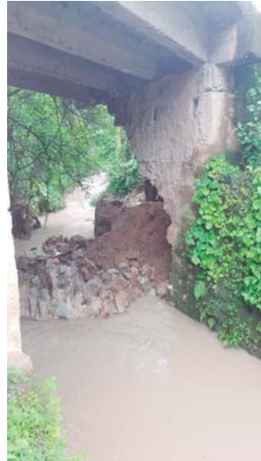
Las bases del puente del barrio San Antonio, Siguatepeque, también están socavadas.
