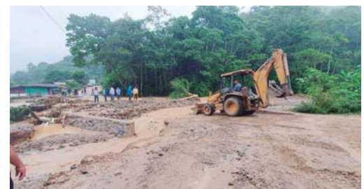
Con maquinaria pesada se ejecutan tareas de rehabilitación de tramos carreteros afectados por el desbordamiento de los arroyos, como a la altura de Las Quebradas, Trojes.
