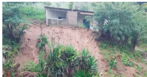
Casas a punto de derrumbarse con todo y cerros donde fueron construidas en la zona de Los Almendros, en el rumbo a Trojes.
