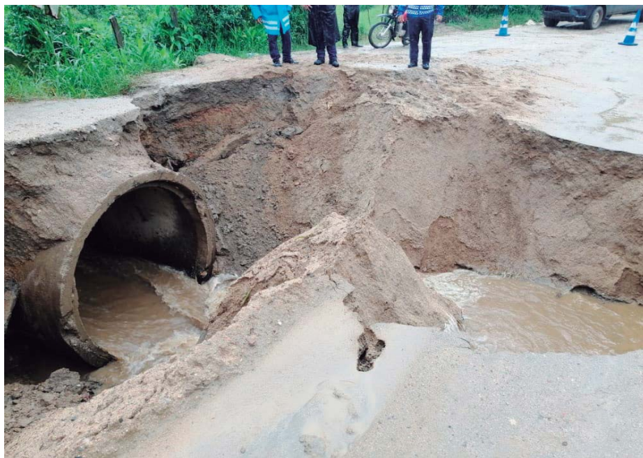
La enorme corriente provocó el colapso de una caja puente y corte en la carretera hacia Trojes, El Paraíso.
