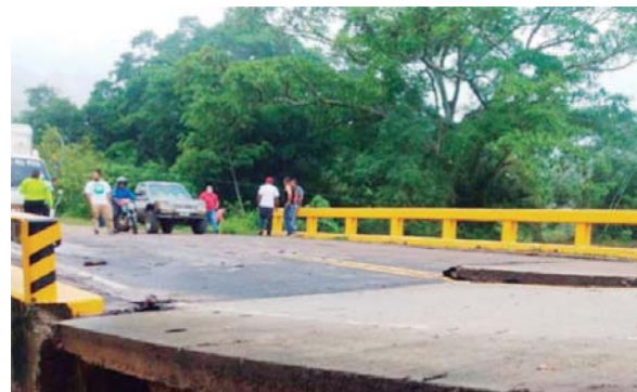
El puente Galeras está muy dañado y ya no soporta ningún peso.
