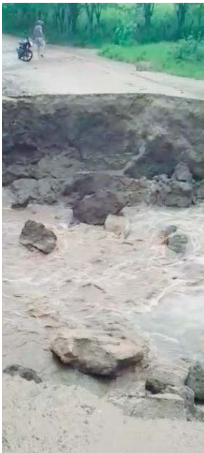
Cortes en las carreteras como este en la vía hacia Chindona, Gualaco.
