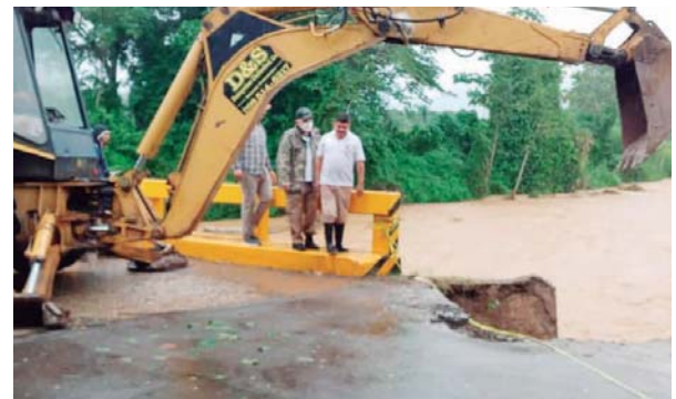
37 puentes destruyeron Iota y Eta.
