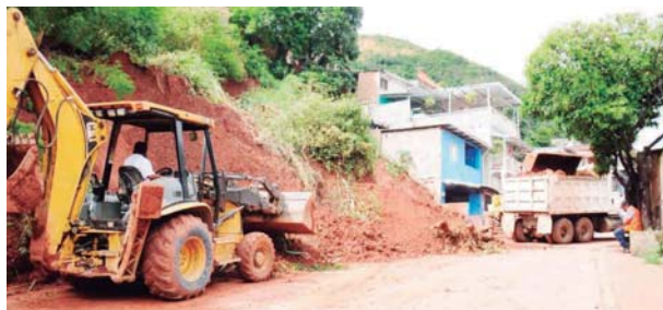
Uno de los últimos derrumbes registrados sucedió en la zona del barrio El Chile justo en la calle que conecta con la colonia Cerro Grande.
