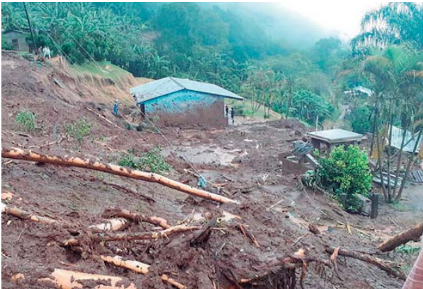
Las autoridades evaluaron los daños en las carreteras, ya que son prioritarias para que no se pierdan los cultivos.
