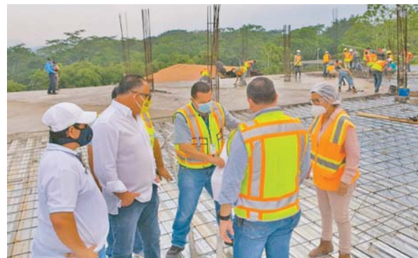
El alcalde de San Pedro Sula inspeccionó la construcción del Macro Distrito Municipal de Salud en Cofradía.
